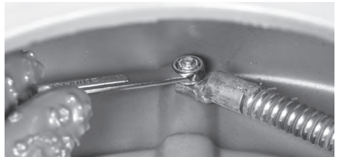
Figura 30 – Perno de anclaje del acoplamiento flexible pigtail
